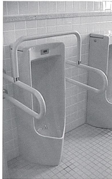
・ストール式小便器と手すりの事例
