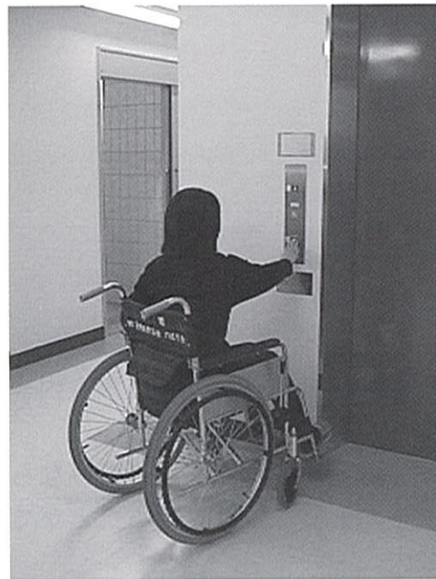
・乗場ボタン（島田土木事務所）
