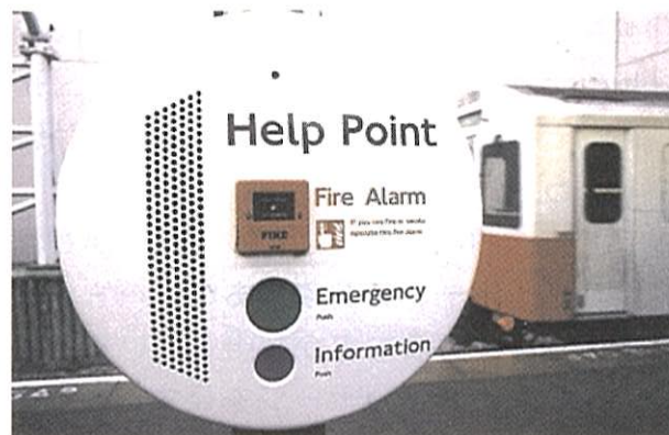
・ヘルプポイントの事例 (イギリス ロンドン地下鉄のホーム)
