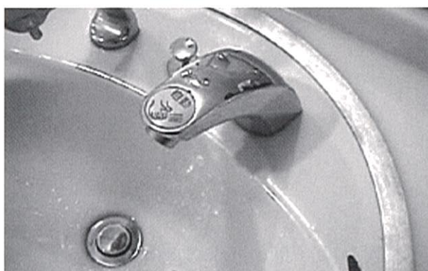
・自動水栓の事例
