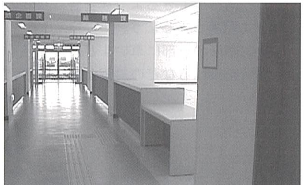
・事務室の受付まで誘導している点字ブロック（島田土木事務所）
