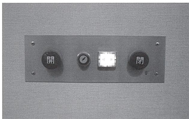
・トイレのボタンスイッチの事例
