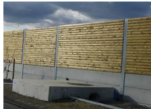
新東名高速道路の遮音壁（掛川市） 公共施設における工作物
