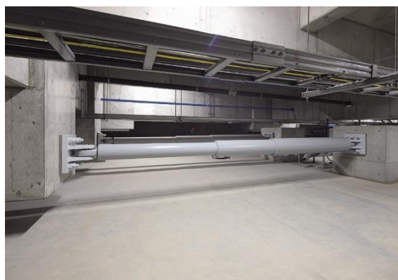
免震層（オイルダンパー）
